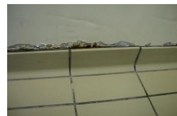
Fig. 2. Usura nei locali di stagionatura
